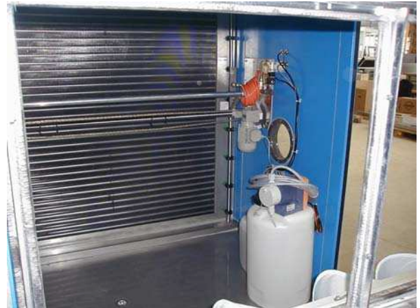
Bild 2: Ansicht eines, im Lüftunggerät eines Kunden eingebauten Abluft-KVS-Tauschers mit softwasch-System zur Reinigung. Im Vordergrund der Reinigungsbehälter mit aufgebauter Dosierpumpe.
